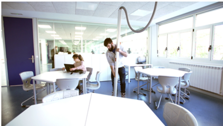
Figur 5.9: Justerbara kolonner med elektriska anslutningar
