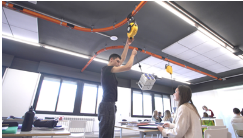
Bild 5.8: Fritt rörliga uttag i taket
